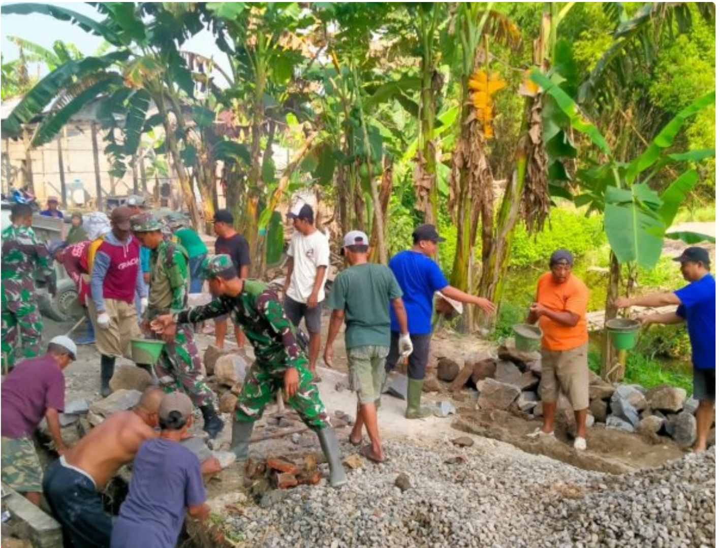
Sinergi TNI Dan Warga, Pembangunan Talud Akses Jembatan Garuda Di Burikan Terus Dikebut
